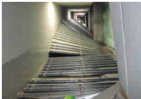
6F-投票廊下壁崩壊
