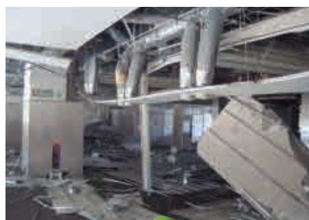
5F-ファンエリア天井崩壊②
